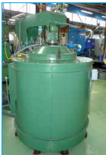
Forno di vaporizzazione Steam tempering plant
